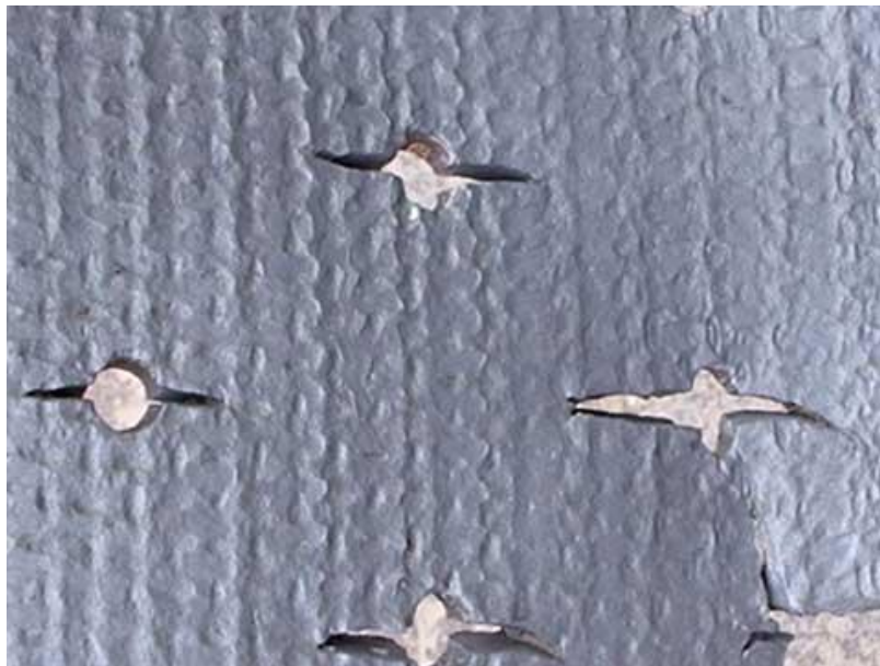
Detalhes da Corrosão e trincas acentuadas e generalizadas (Lado Interno do cesto)
